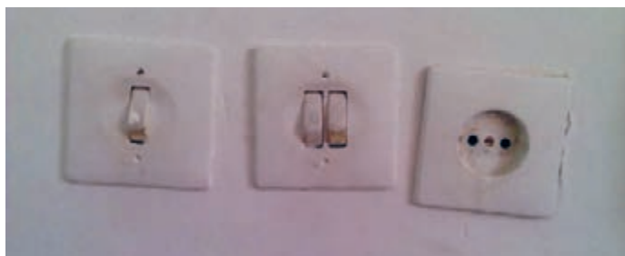
شکل ۱- نصب غلط کلید و پریز
