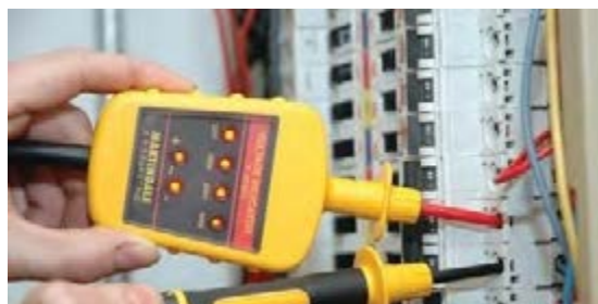
شکل ۵۴- تست تابلو با نشانگر ولتاژ
